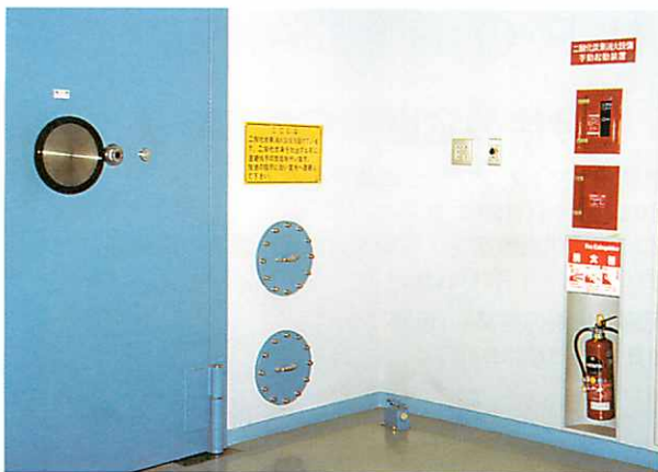
収蔵庫の二酸化炭素による消火設備
